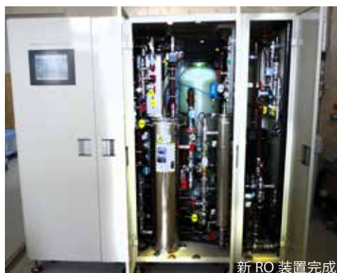
新 RO 装置完成
