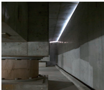
▲ 左が鉛プラグ入り積層ゴム支承。右の壁が地面で建物全体が地面から浮いているのが分かる
