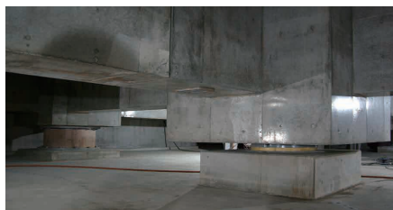
▲ 16 台設置されている回転機構付すべり支承（手前）と 8 台設置された鉛プラグ入り積層ゴム支承（左奥）
