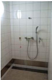
▶各階にあるシャワー室
